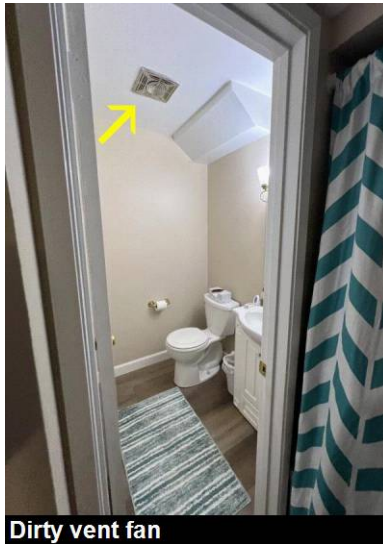
Dirty vent fan
